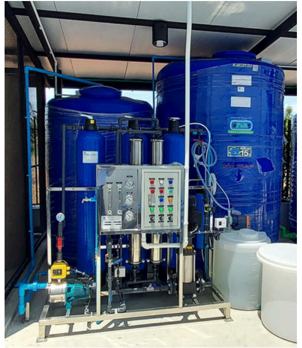
เครื่องกรองน้ำอุตสาหกรรมระบบ Reverse Osmosis (RO)
